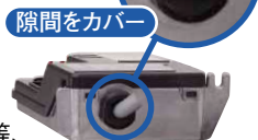
▲電装箱のケーブル取出し部
