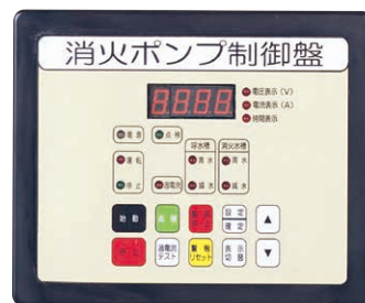
▲制御盤表示部
