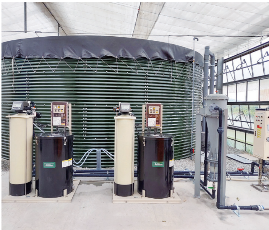
MAE形をはじめとした水処理機器の設置、後方は処理水槽(130m 3 )
