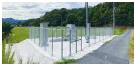
消雪設備外観
