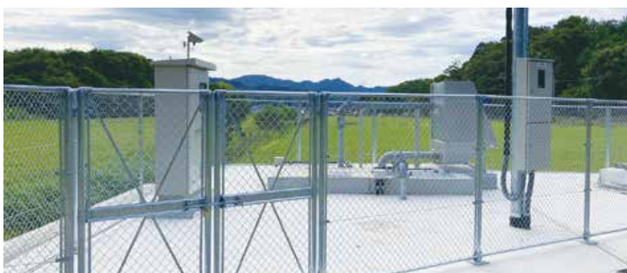
着脱式水中ポンプ(BU4形)・ステンレス製水中タービンポンプ(KUR形)設置
