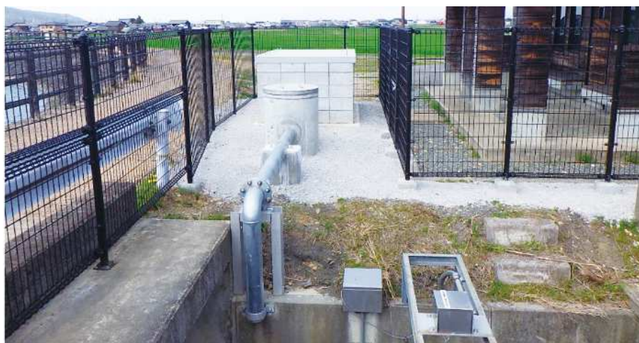
ポンプ設置場所①
