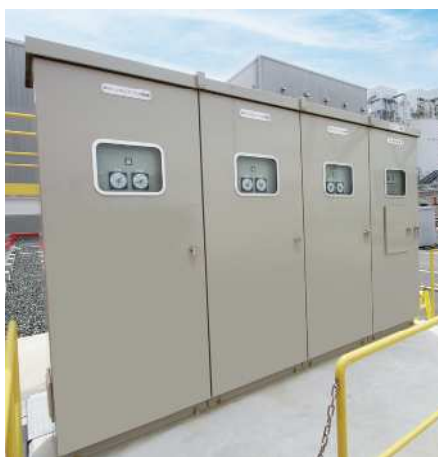
所内用水ポンプ用特殊制御盤
