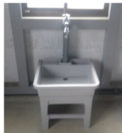
屋内に設置された水栓
