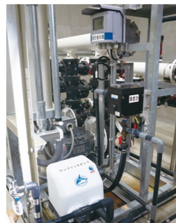
ユニット内のサンプリングポンプ
