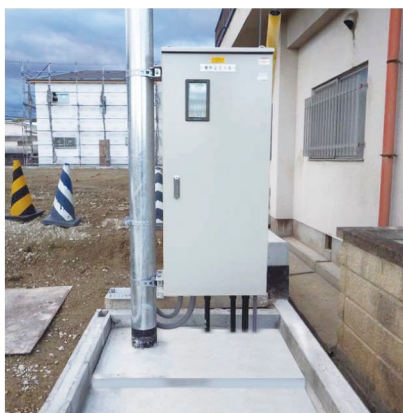
ECDW3形制御盤設置(特殊仕様品)
