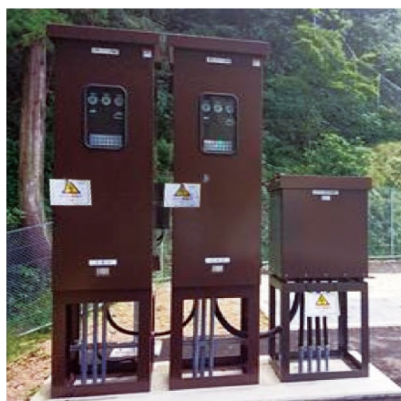
EC-S形消雪制御盤 その1
