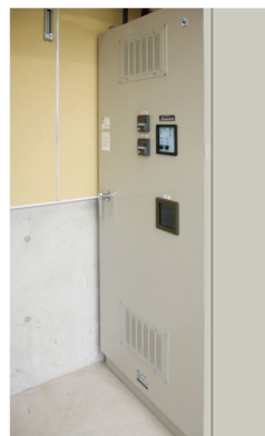
インバータ制御盤
