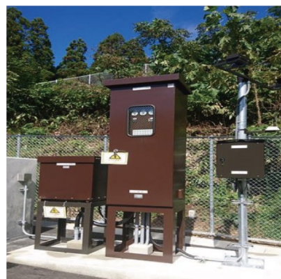
EC-S形消雪制御盤 その2
