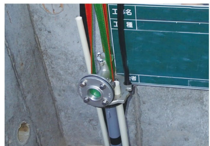
特殊仕様の揚水管と井戸蓋上部
