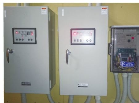
各ポンプの制御盤
