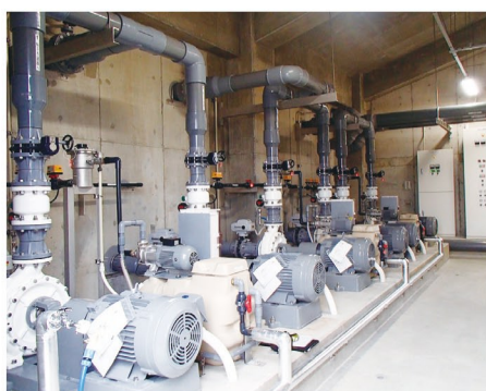
海水取水ポンプ
