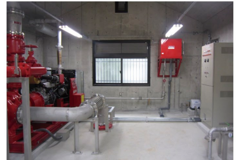
消火ポンプユニットと制御盤
